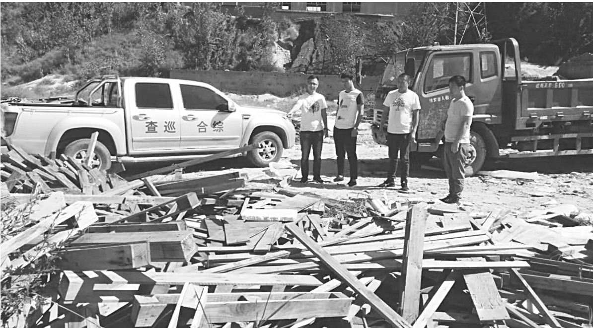
综合巡查人员发现散乱污现象反弹，及时反馈并监督垃圾清理。
