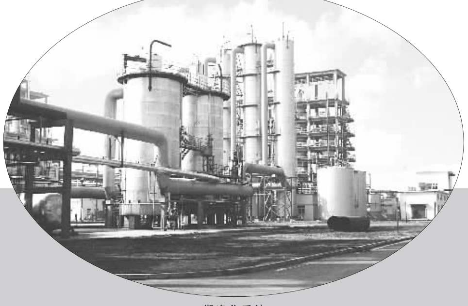
一期净化系统
