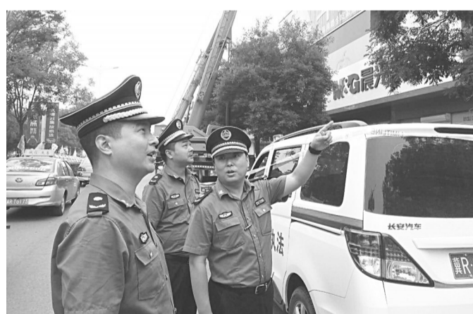
霸州市城市管理综合行政执法局自5月16日起全面开展违规楼顶广告拆除行动。该局采取“地毯式”执法，逐街逐路对违规楼顶广告依法实施强制拆除。目前，累计出动执法人员660余人次、执法车辆280余辆次，下发法律文书820余份，拆除主次干道两侧楼顶广告135处，拆除楼顶广告字1008块，消除了安全隐患，净化了城市空间。图为违规楼顶广告拆除现场。崔莹 夏卫超 摄
