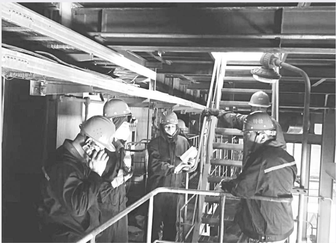
国庆节期间,迁安市质监局特种设备检验人员、监察人员会同河北省特检院唐山分院检验专家来到迁安市九江线材有限公司锅炉使用现场开展检验、监察工作。经检验,检验人员发现锅炉主给水管焊接接口有条形夹渣,提出检验修复意见,并结合“双起”锅炉的特点有针对性地提出了运行、维护建议。
