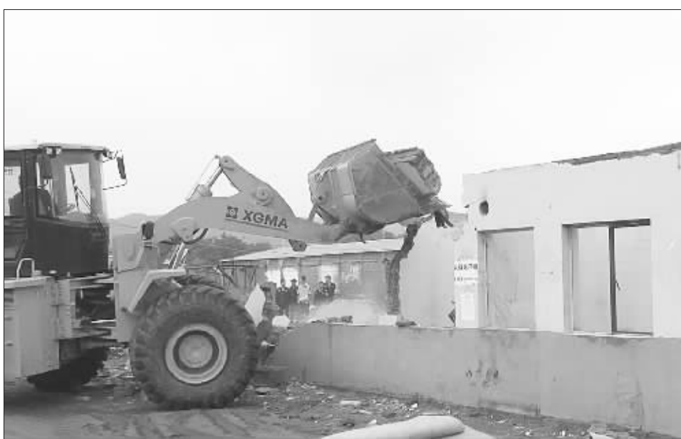
近日,丰宁满族自治县拆迁办在大阁镇政府、公安局、等部门的积极配合下,由县城管局组织40余名执法人员,动用两台大型机械设备,对该县北新区9处违法建筑物进行了强制性拆除,拆除面积800余平方米。
