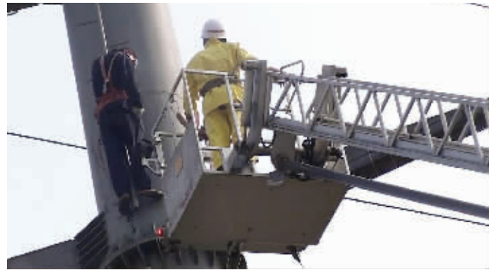
10 月 24 日 12 时 32 分,泊头市消防大队接到群众报警称:位于该市 104 国道石油库南 200 米堤口张村模具厂附近,一电厂工人被高压电击伤,身体大部分失去知觉,困在高压电线杆上,情况非常危急,急需救助。接到报警后,该大队立即出动一部抢险救援车和一部登高平台消防车前往处置,最终将该男子成功救下。图为营救现场。王成成 摄
