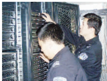
朱金磊与民警在机房检查服务器运行情况,保障监控系统的正常运行。
