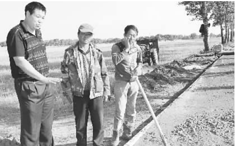
图为省质量技术监督局驻村干部皮国斌(左一)在道路硬化施工现场查看施工进度。 本报记者 盖媛媛 摄
