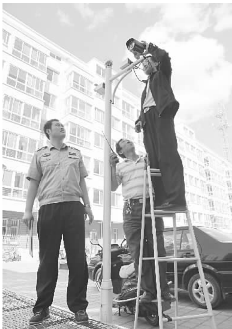
为进一步提升视频监控的使用效能,平泉县公安局大力开展“天网覆盖”工程建设,在主要路口、火车站、广场、金银首饰店、大型超市、娱乐场所、金融网点等重要部位科学布点,安装视频监控网络。图为技术人员在社区调试高清视频监控探头。本报记者 龚红美 摄
